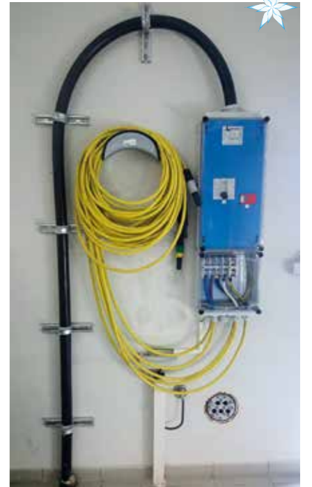
Notstromeinspeisestelle im Pumpwerk Lengefeld
