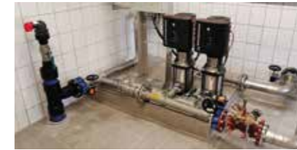
Druckerhöhungsanlage Neudorf Karlsbader Straße
